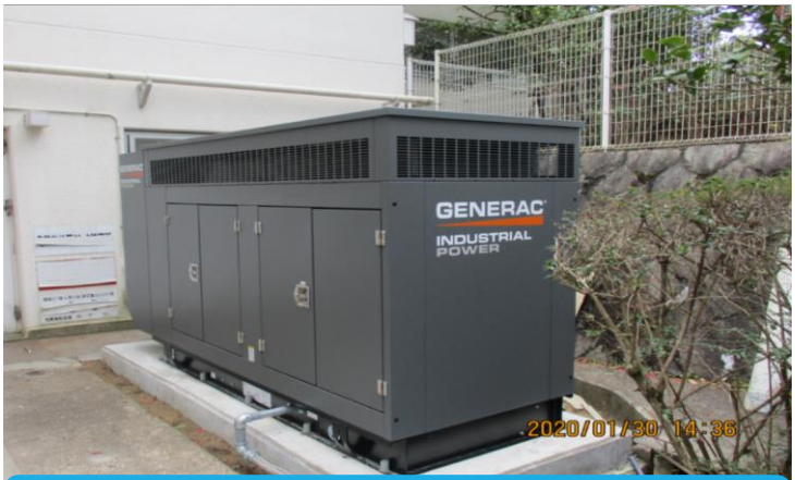
大型の自家発電機
