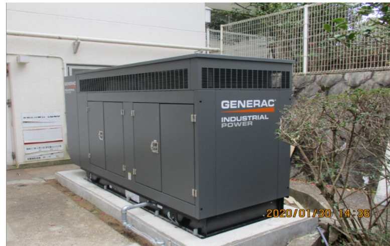
大型の自家発電機
